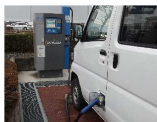
EV急速充電器
