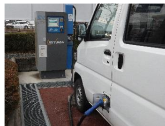
EV急速充電器
