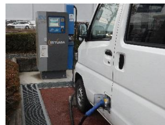
EV急速充電器
