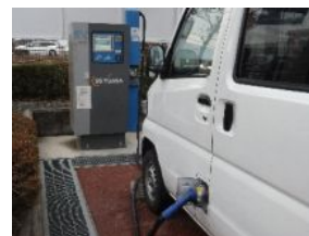
EV急速充電器
